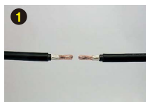
ケーブル処理
